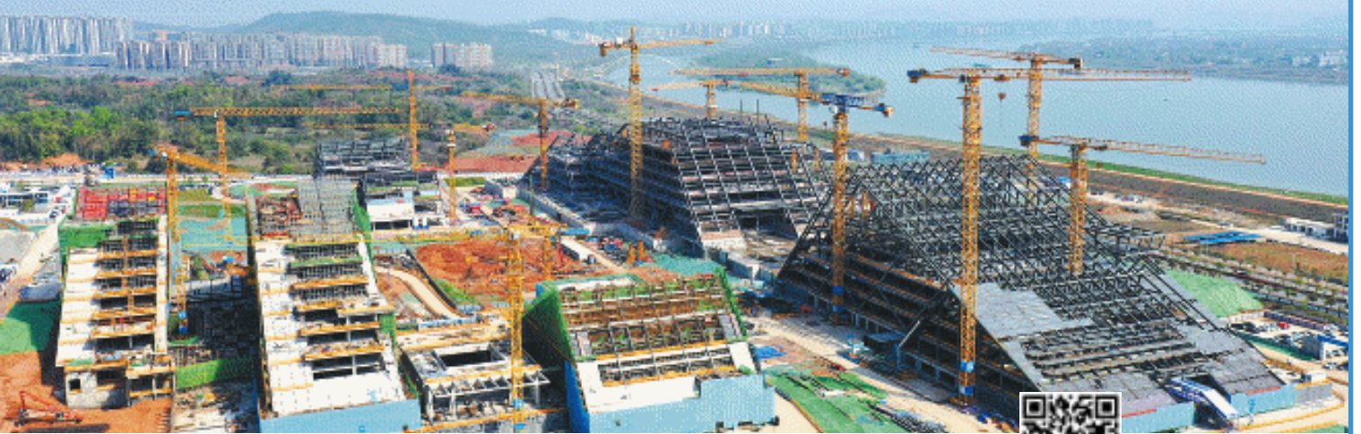
湘江科学城科学交流中心提前58天实现主体结构封顶,标志着湘江科学城首开区“五大建”主体结构已全面完成封顶。长沙晚报全媒体记者 王志伟 摄
